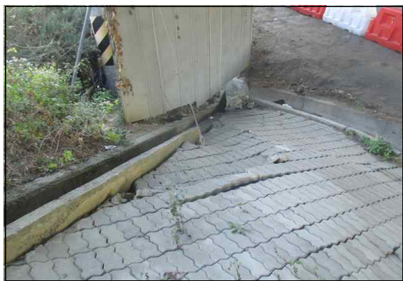
교대 법면 침하/공동(A1)
