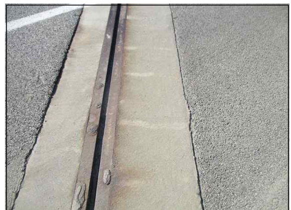
신축이음 후타재 균열(A1)
