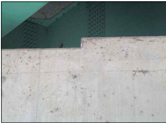
교각 코핑부 균열(P1)
