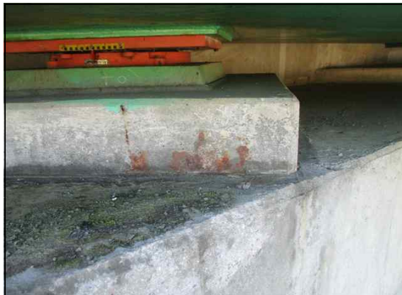
받침콘크리트 녹물유출(A2 SH1)
