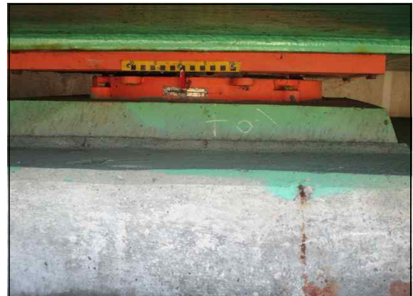
받침물탈 균열(A2 SH3)
