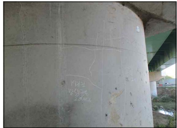
교각 기둥 망상균열(P2)
